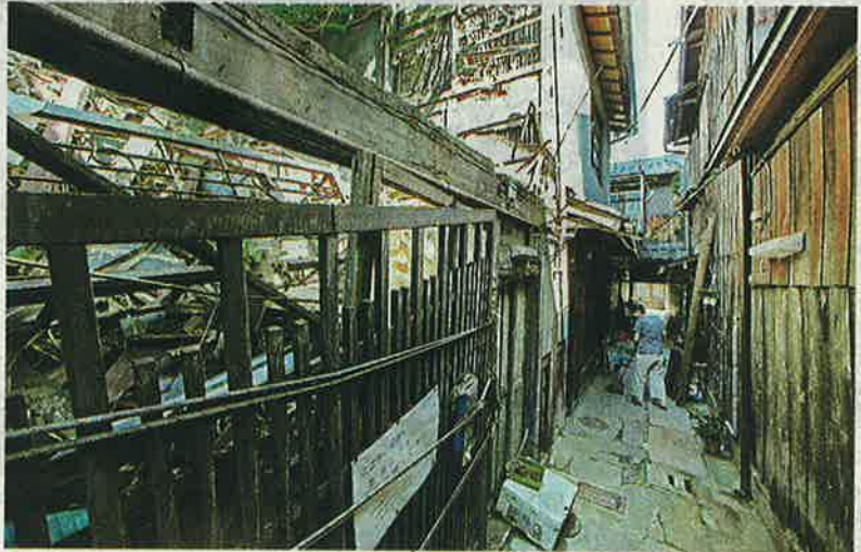
3軒続きの長屋の1軒。倒れそうな壁を押しとどめるのはロープのみ。柱はシロアリに食われ、スカスカだった。壁の上部にはさび付いたガス管が通っている。近隣の住民は「地震が来たら」とおびえていた(京都市東山区) 撮影・奥村清人
